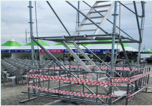
〈조명탑 안전웬스 및 안전선 설치〉
