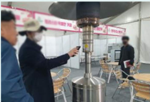
〈 부스 내 야외용 가스난방기 설치 부적절 → 추후 제거 〉
