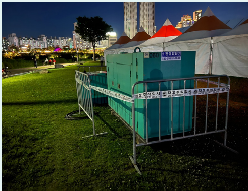
〈발전기 접근금지 웬스 설치〉
