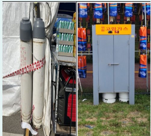
〈가스용기 기둥에 고정, 보호캡 설치, 가스용기 보관함 설치〉
