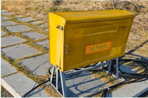
〈분전함 시건장치 부재〉
